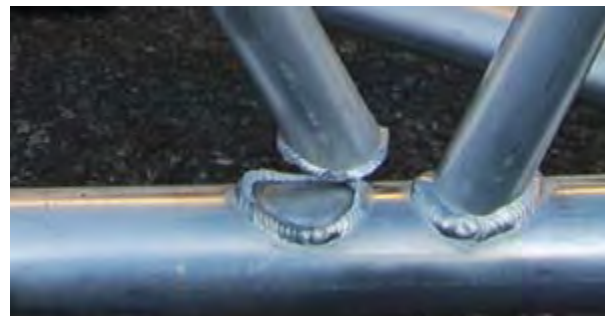
Materialermüdung in der Wärmeinflusszone
